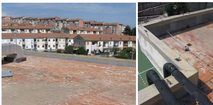
Figura 5: Alcune delle non conformità rilevate nella struttura
